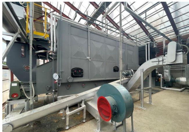
写真:トップファームに設置したバイオマスボイラー
