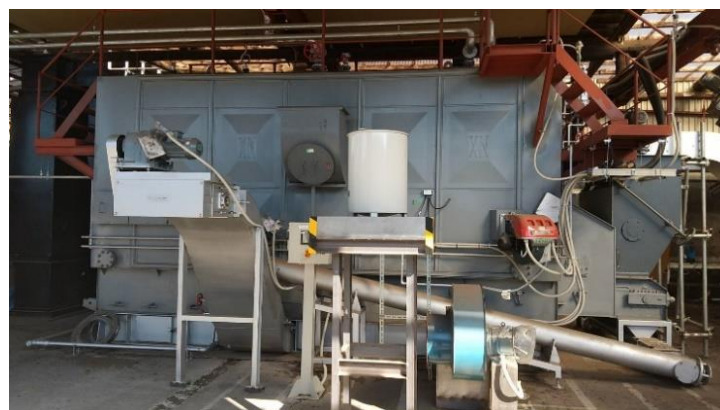
写真:リオグランデに設置したバイオマスボイラー
